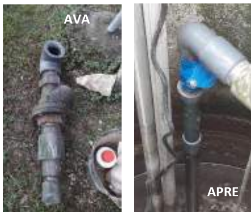
Poste de relevage d'entrée- clapet de pompe
