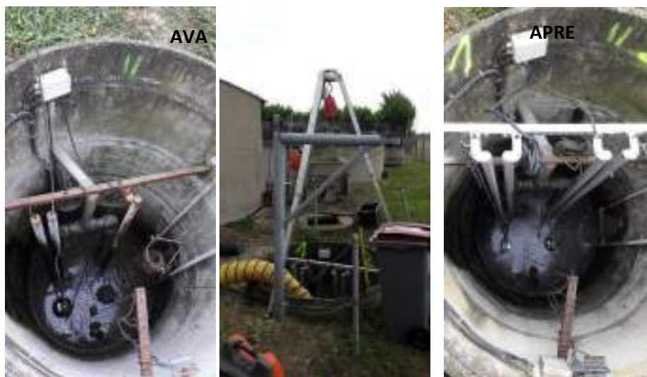
Pompe N°1 XYLEM au fond et sur les 2 pompes, les barres de guidage, supports et chaînes en inox)
