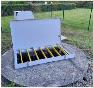
Renouvellement d'un capot et mise en place d'un barreaudage pour chaque poste de relèvement sur le réseau d'eaux usées
